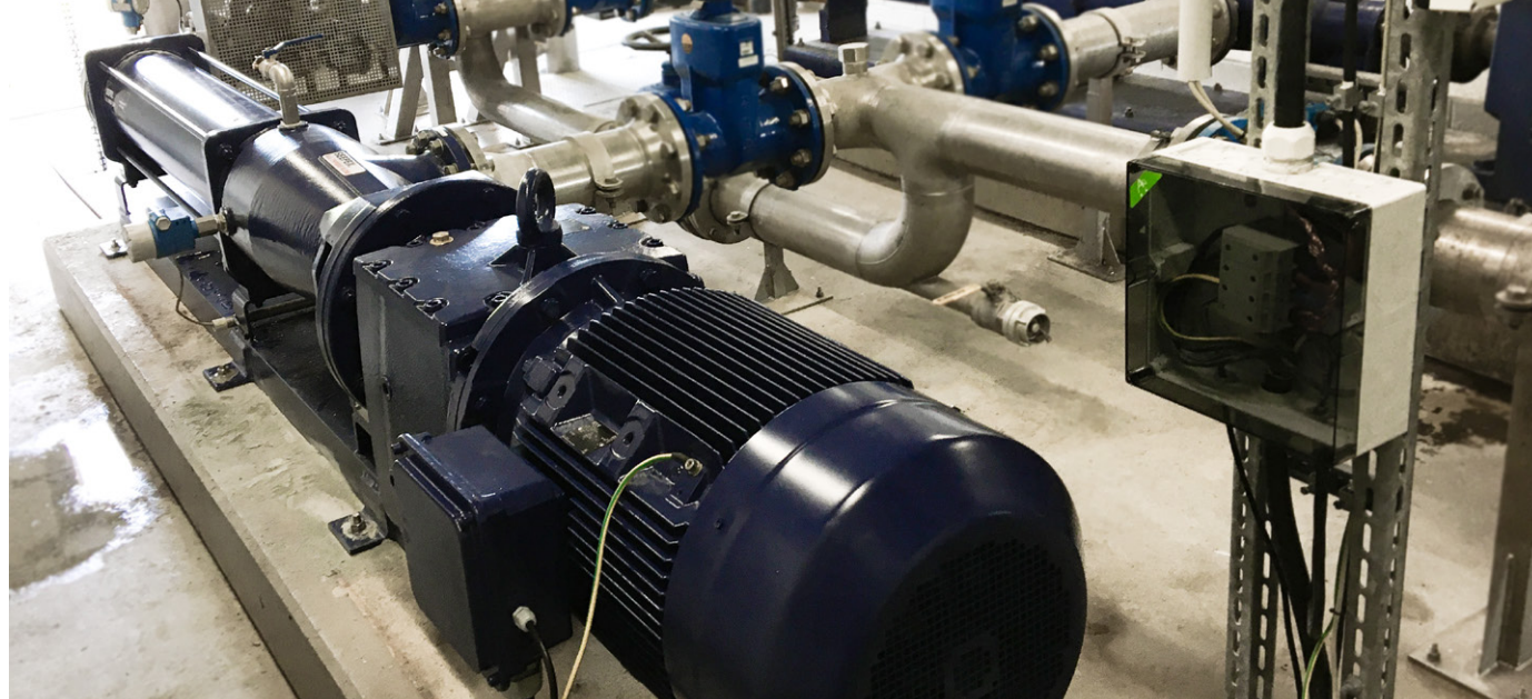
SEEPEx Pump Monitoring à la station d'épuration d'Essen-Sud.
