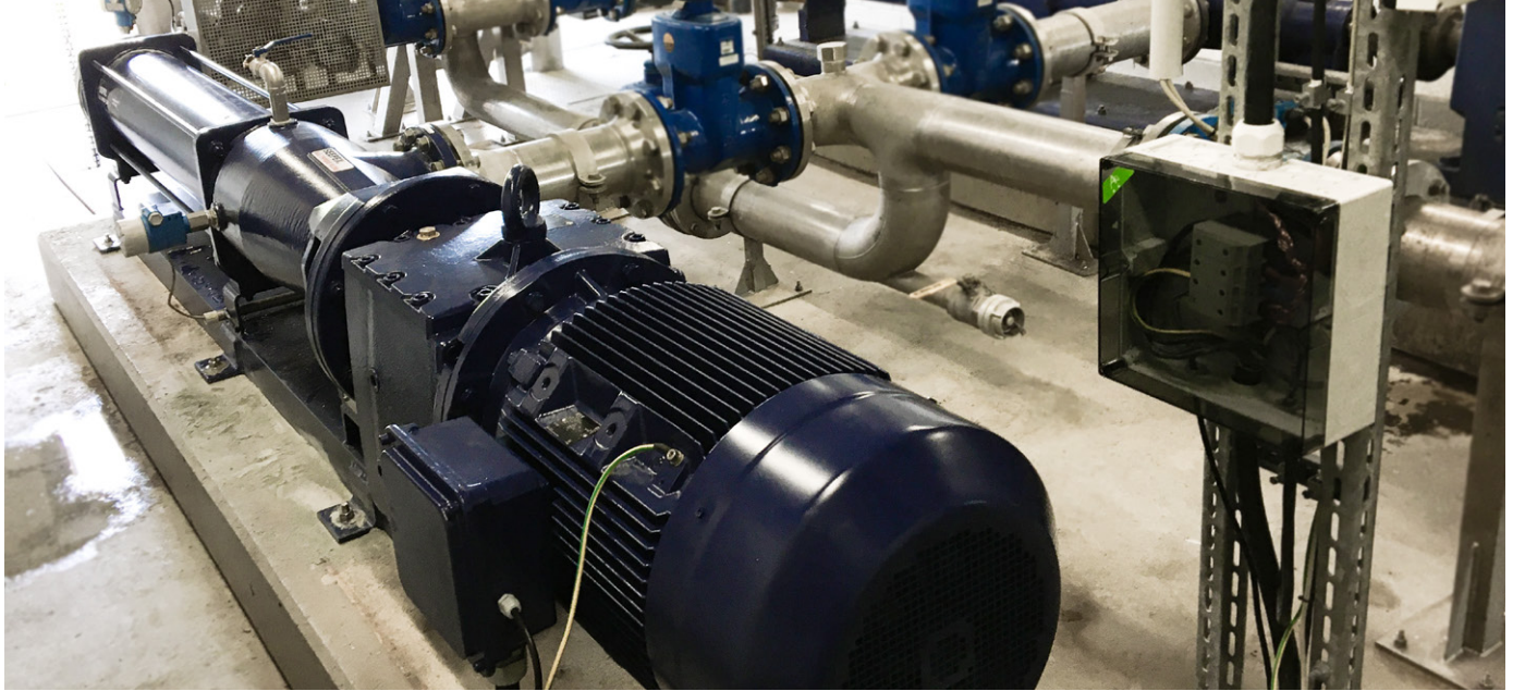
SEEPEx pumpövervakning vid avloppsreningsverket i Essen-Syd.
