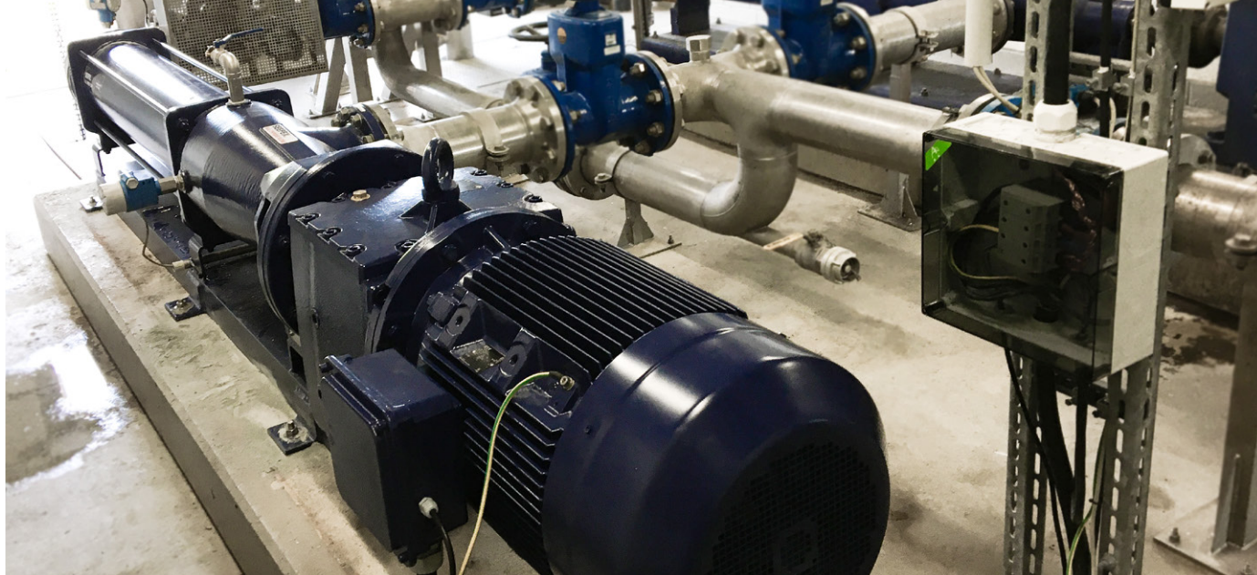
Monitorowanie pomp SEEPEX w oczyszczalni ścieków Oczyszczalnia ścieków w Essen-Południe.
