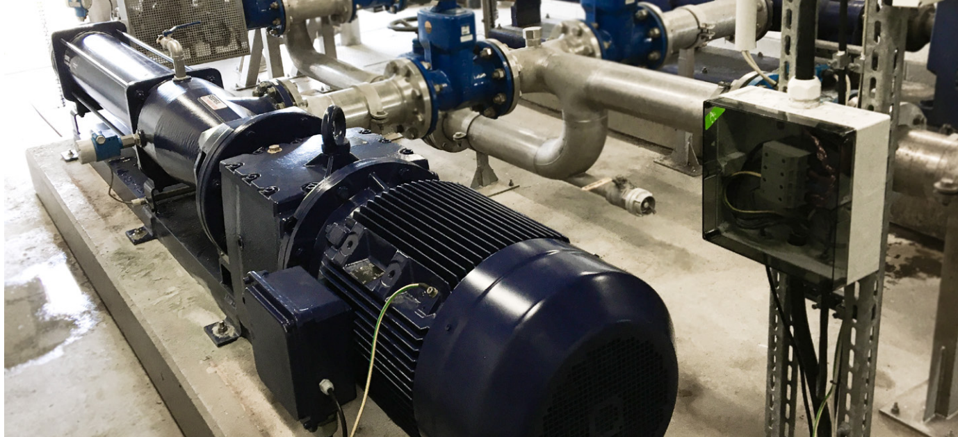
SEEPEX pumpeovervågning på spildevandsanlæg i Essen-Syd.
